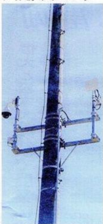
新たに取り付けられた長距離無線通信設備とライブカメラ
